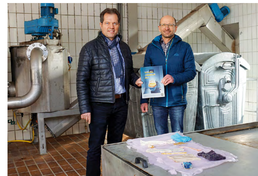
Infrastrukturstadtrat Rainer Widmann mit dem Geschäftsführer des Reinhaltungsverbandes Freistadt und Umgebung, Gerhard Kerschbaummayr, vor dem Fangrechen der Kläranlage mit schädlichen Abfallresten.
