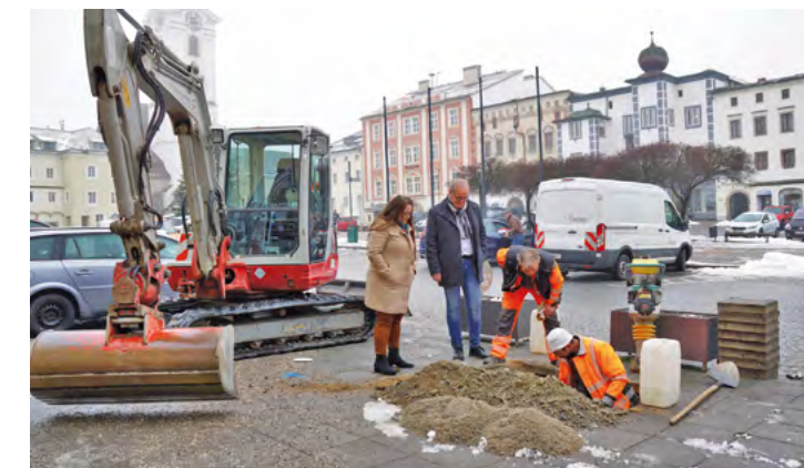
Erste Vorbereitungsarbeiten für unsere neuen Bäume am Hauptplatz: Bürgermeister Christian Gratzl und Bauabteilungsleiterin Bianca Weißenböck schauen unseren fleißigen Bauhof-Mitarbeitern beim Probeschürfen über die Schultern.
