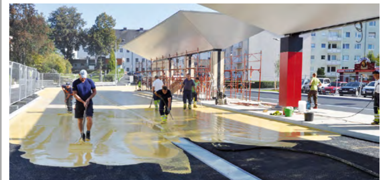
Die halbstarre Deckschicht wird im Haltestellenbereich aufgetragen. Eine falsche Rezeptur des Füllstoffes führte zu den Abplatzungen.
