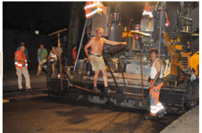
Ab 30. Juli ist auf der B 310 wieder „Nachtschicht“ angesagt. Die zweite Etappe der Straßensanierung wird in Angriff genommen und mit Sicherheit ebenso rasch und problemlos über die Bühne gebracht wie die erste.
