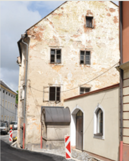
Für viele Betrachter ein kleiner Schandfleck der Stadt! Das Haus Heiligengeist-Gasse 4 erhält noch heuer eine neue Fassade und neue Fenster. Bis zur Eröffnung der Landesausstellung wird es dann endgültig in neuer Pracht dastehen.
