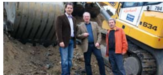
Schnell geräumt: In nur 60 Tagen soll die Räumung der ehemaligen Deponie abgeschlossen sein.
