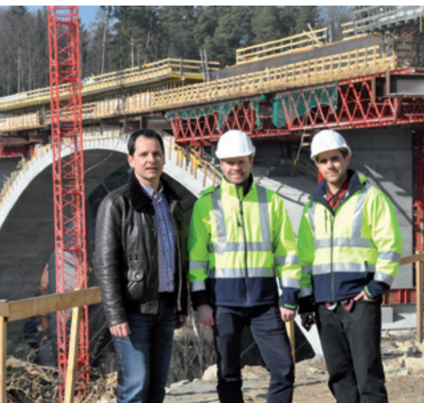
Die Brücke wächst Tag für Tag! Und sie steht - entgegen aller Gerüchte - auf sehr festen Fundamenten, wie sich Bürgermeister Christian Jachs bei einem Baustellenbesuch überzeugen konnte. DI Mattia Canali und DI Ahmet Osmanovic, die beiden Bauleiter von GKConstructions, können sich ebenfalls nicht erklären, wie derartige Vermutungen zustandekamen.
