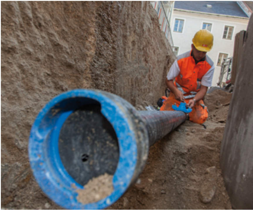
Allein in der Innenstadt wurden heuer 1,3 Millionen Euro in Wasser- und Kanalprojekte investiert. Und die Stadtgemeinde bemüht sich auch weiterhin um laufende Erneuerungen.
